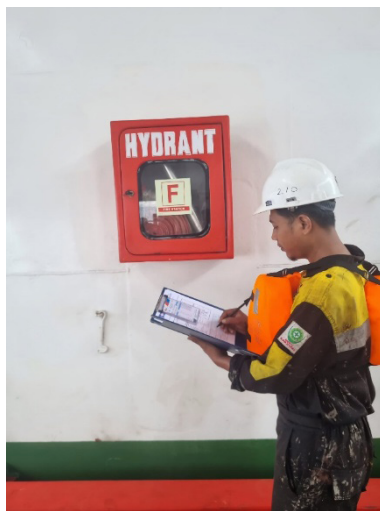
Pemeriksaan fungsi hydrant spray dan selang nosel
