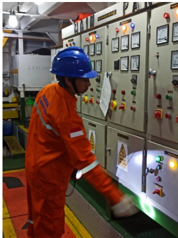
Pengecekan rutin aliran listrik
